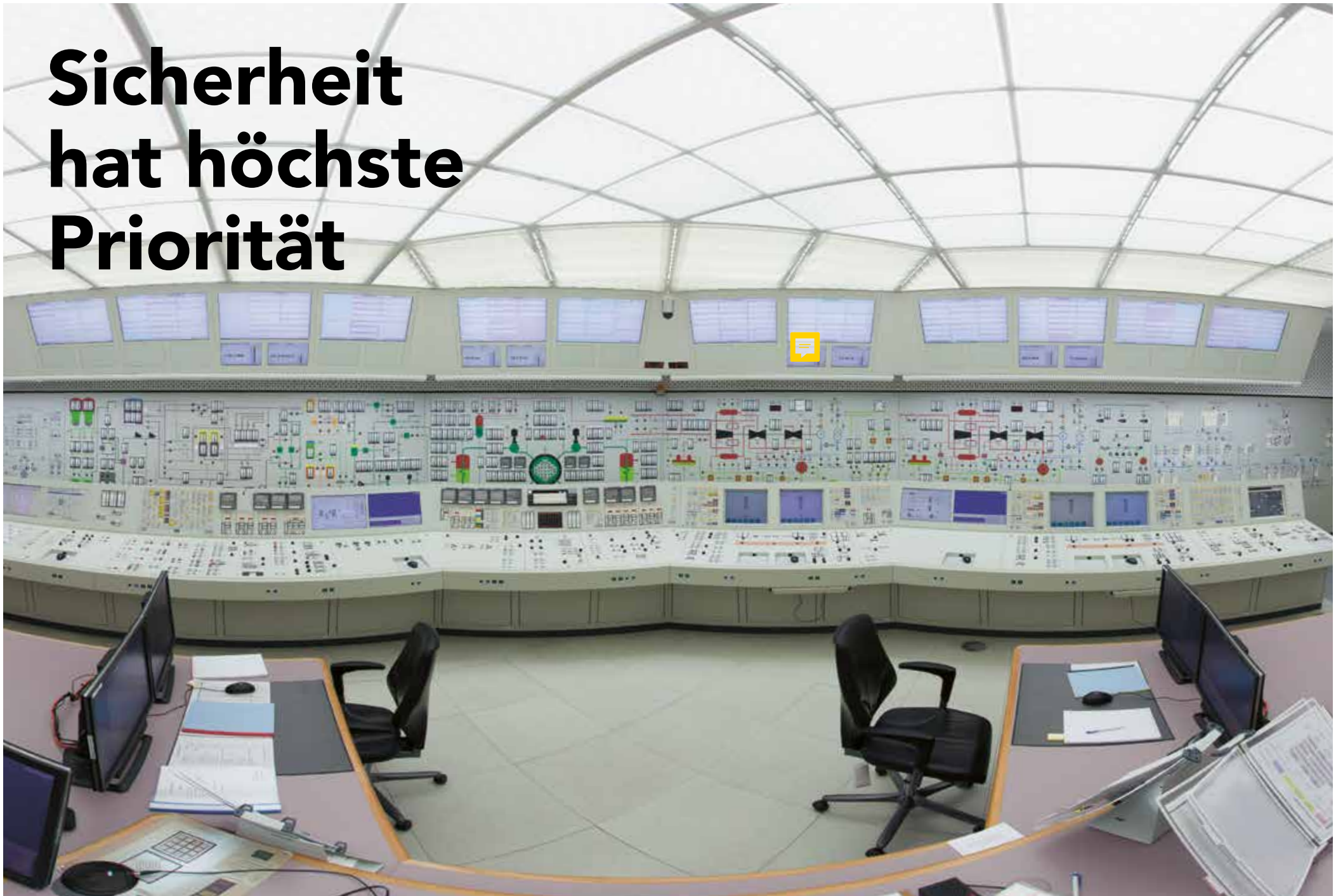
Im Kommandoraum wird der Betrieb überwacht.
