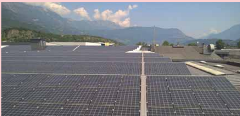
Impianto fotovoltaico da circa 1 MW, Rovereto, Trentino
