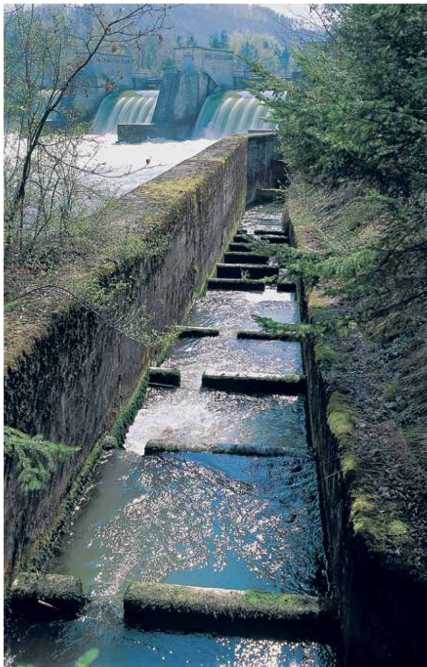
Freie Bahn für die Flusstiere: Fischtreppe beim Kraftwerk Wildeg-Brugg.
