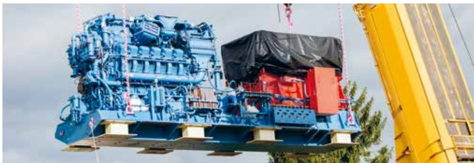
Einer von vier neuen Dieselgeneratoren für eine autarke Notstromversorgung.
